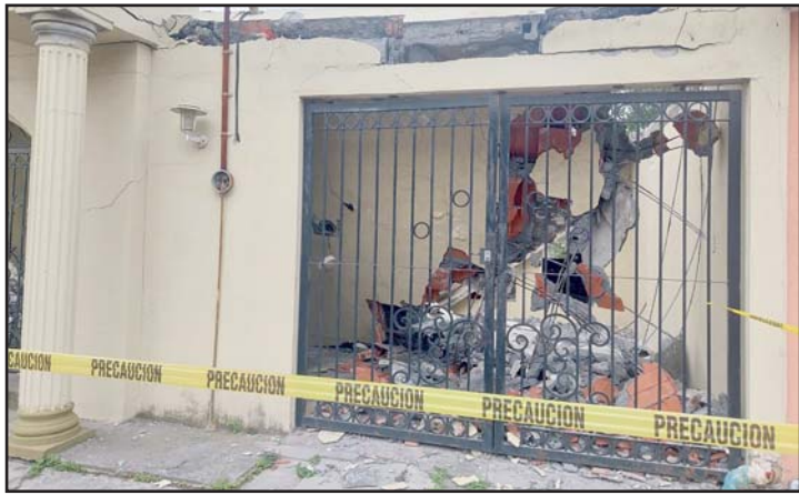
Parte del techo de la vivienda colapsó.
