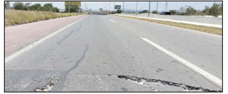
A lo largo y ancho se pueden ver daños en la carpeta asfáltica.
