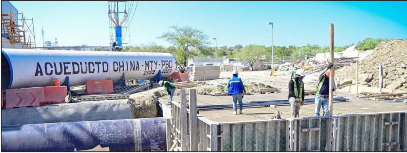
El mandatario lo dijo al realizar una última supervisión de los trabajos del acueducto El Cuchillo II.
