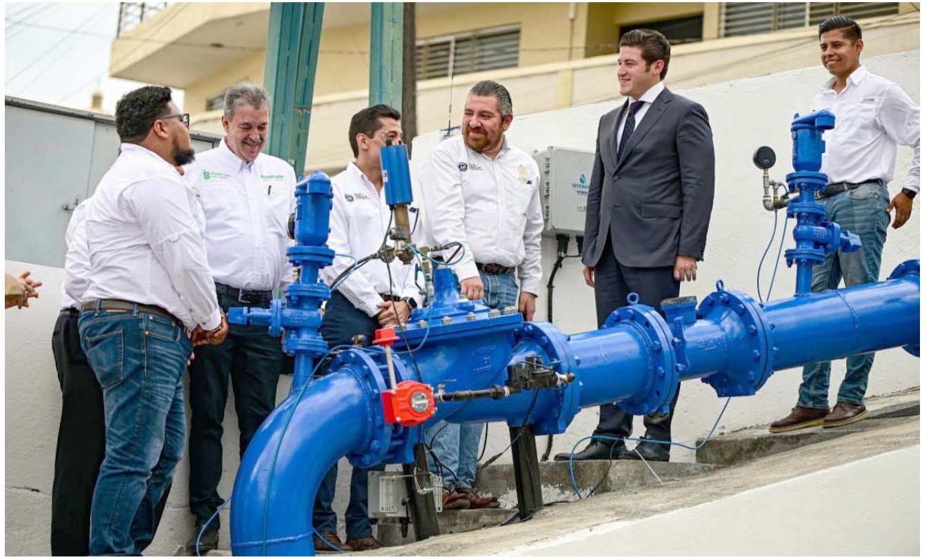
El gobernador anunció que ya llegó a la Planta de Bombeo 3, por lo que todo va a buen tiempo.
