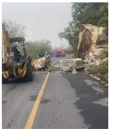
Hubo deslaves en la carretera Montemorelos-Rayones.
