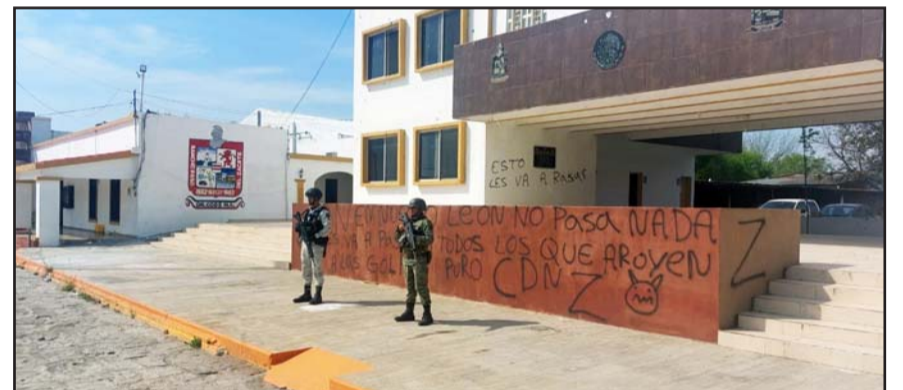
El palacio municipal amaneció con pintas sobre sus paredes con amenazas, además se registraron impactos de bala a el DIF Municipal y una vivienda.
