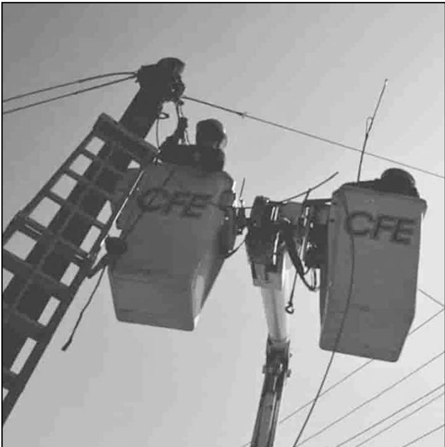
Se brindará el respaldo del suministro eléctrico con 692 trabajadores operadores de 333 plantas de emergencia.
