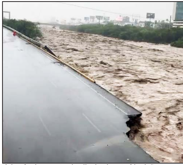
Además de muertes las lluvias han traído daños.
