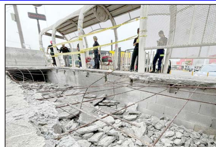
Repentinamente colapsó el piso del lugar.
