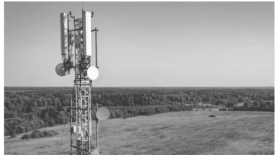
Con la operación, CFE operará con Altán Redes en el mercado mayorista
